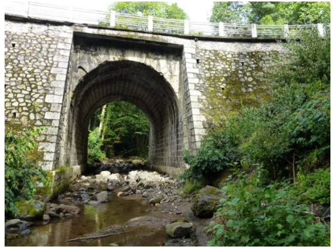
Pont en maçonnerie affecté de divers désordres : radier en mauvais état, dégradation des bandeaux et défaillance de l'étanchéité
