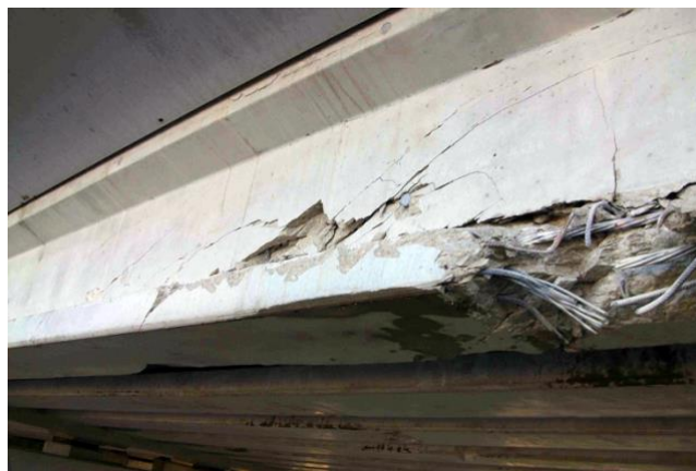
Sécurité structurale compromise à la suite d'un choc mais également sécurité d'usage compromise du fait du risque de chutes de blocs de béton sur la chaussée en contre-bas
