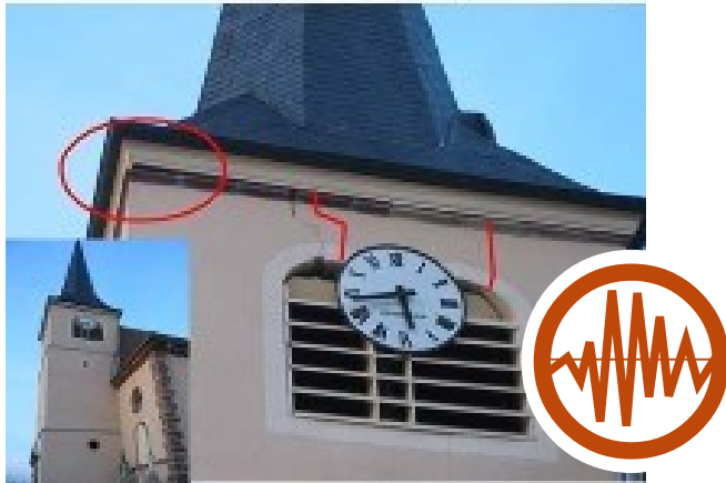
Conséquence du séisme de Rambervillers (88) de 2003
