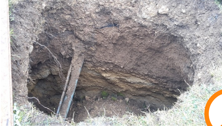
Effondrement rue Landrecourt – Dugny sur Meuse – janvier 2019
